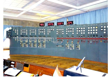
La salle de contrôle
