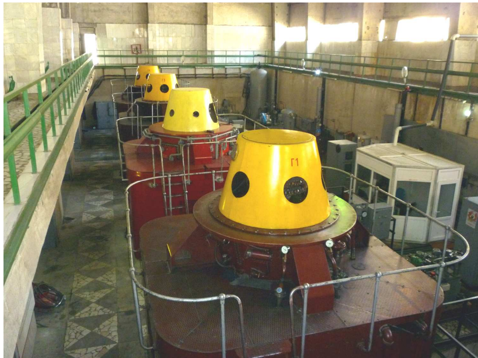
La salle des turbines de la station hydroélectrique Pamir 1
