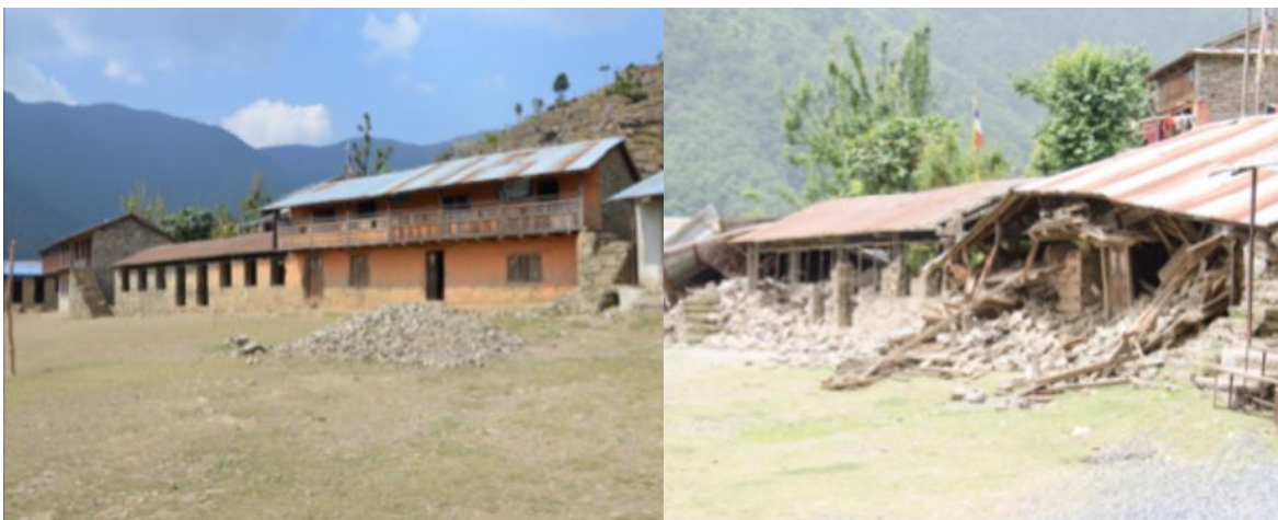
Fig. 9. L'école principale de Salmé en 2014 (© B. Ripert) et après le séisme (© D. Blamont)
