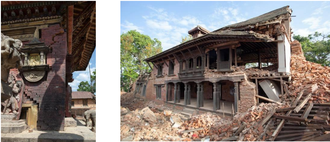
Fig. 6. Fissures sur le temple principal de Changu Narayan à gauche ; le musée des traditions populaires à droite. ©J. Giambrone, mai 2015.
