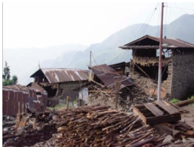
Fig. 7. Fragilité des pignons, Salmé (© D. Blamont)
