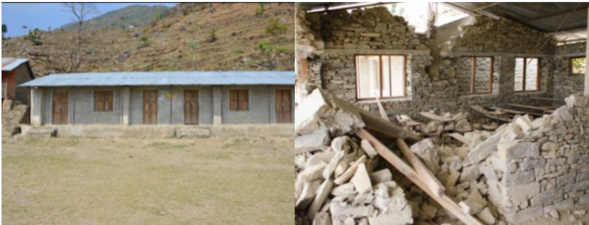
Fig. 8. Bâtiment cimenté de l'école avant (© B. Ripert) et après le séisme (© D. Blamont)
