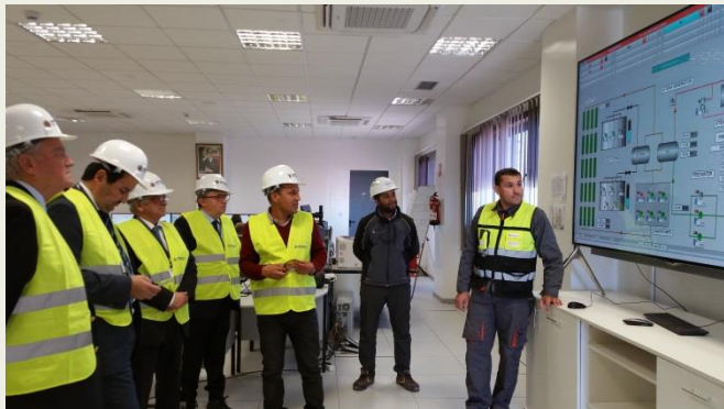
Le poste de contrôle
