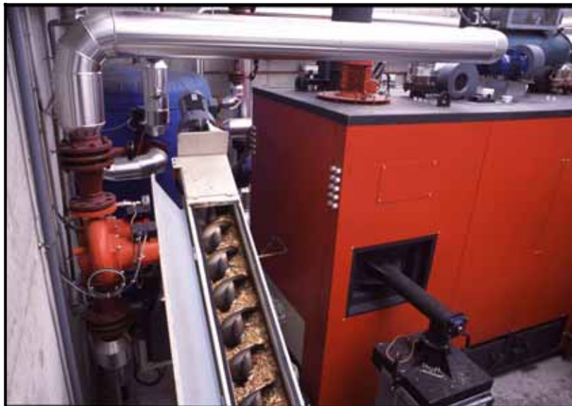
Arrivée du bois combustible dans une chaudière
