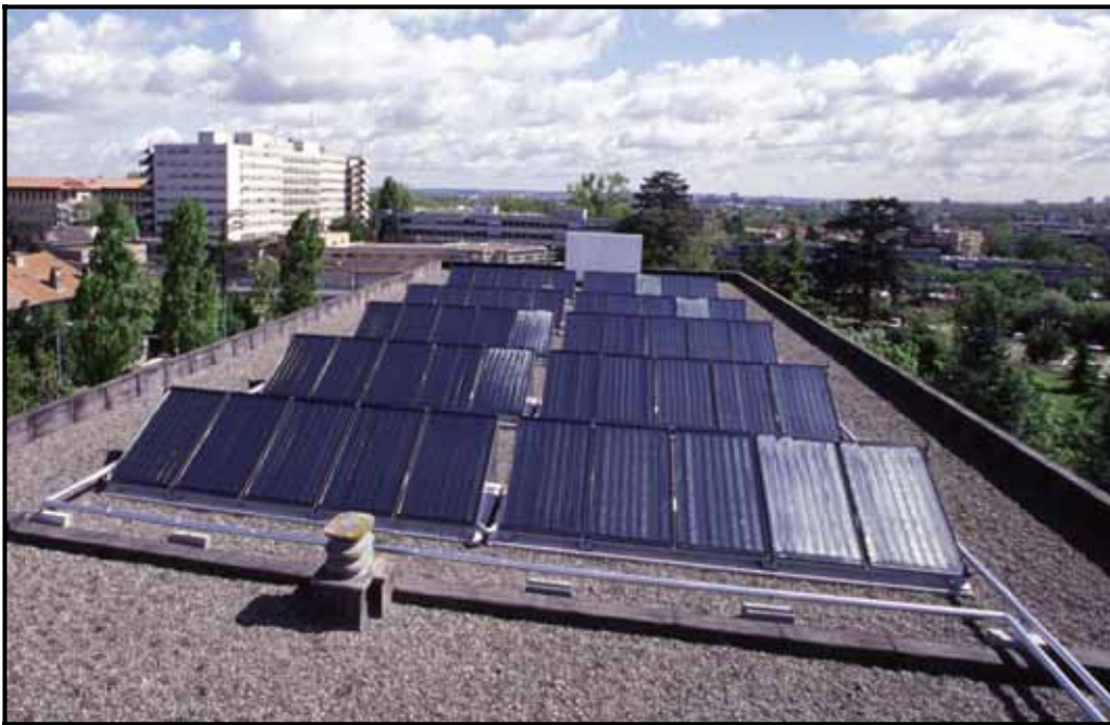
Capteurs solaires thermiques destinés à l'alimentation en eau chaude sanitaire installés en toiture de l'hôtel Novotel à Toulouse
