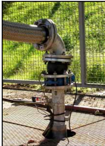
Tête de puits géothermique à Jonzac (Charente-Maritime)
