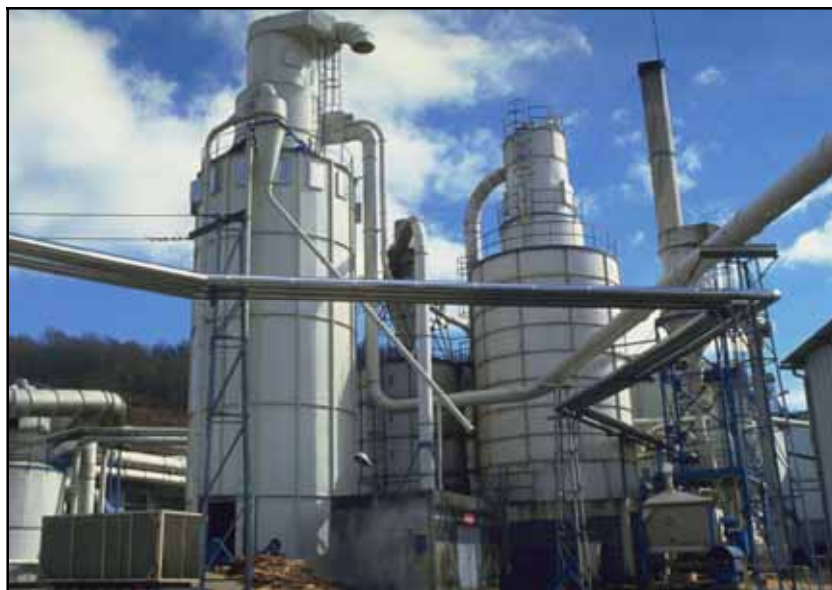
Unité de cogénération bois à Ydes (Cantal)
