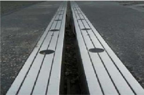
Illustration 7: Joint de chaussée culée CD – Déchirement complet sur 1 élément
