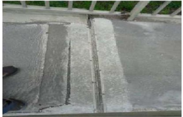
Illustration 8: Joints de trottoirs – Présence de gravats dans les souffles
