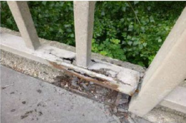
Illustration 5: Garde corps – Gonflement et éclatement lisse intérieure
